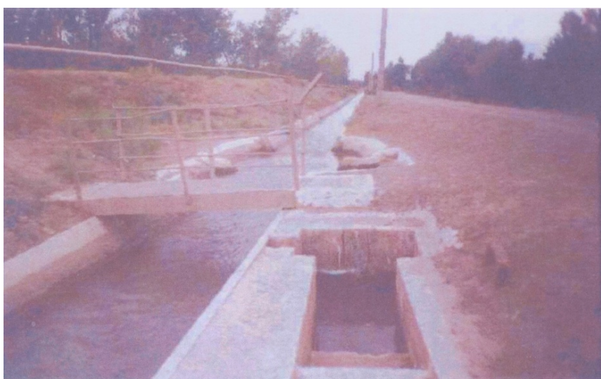
Гидропост на лотковой оросительной сети
