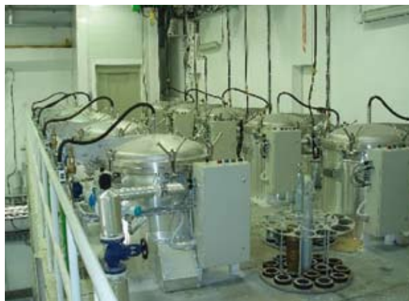
Imagen 6.1: Fusión de TNT con autoclaves en una factoría de destrucción de munición (Ankara) (imagen cedida por NAMSA)
