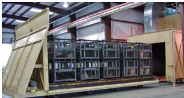
Imagen 4.5: Instalación de descontaminación mediante gas caliente. La vagoneta ha sido cargada con cestas metálicas que contienen munición que ya fue sometida previamente a otro tratamiento.
